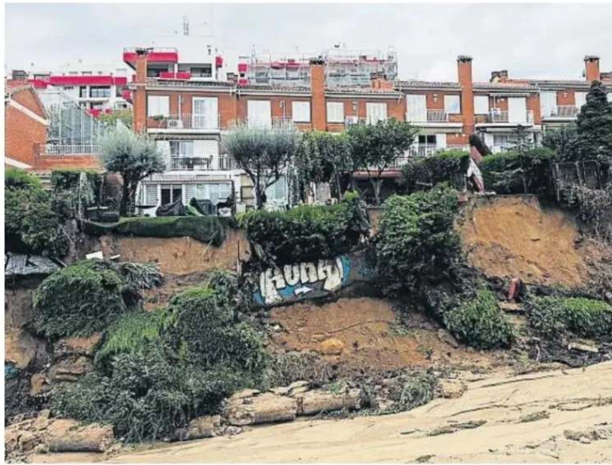
La riera de Alella a su paso por el Masnou, socavó los cimientos de varias viviendas
